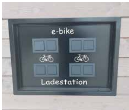
Eine Ladestation für E-Bikes wurde im Buswartebereich am Ortsplatz integriert.
